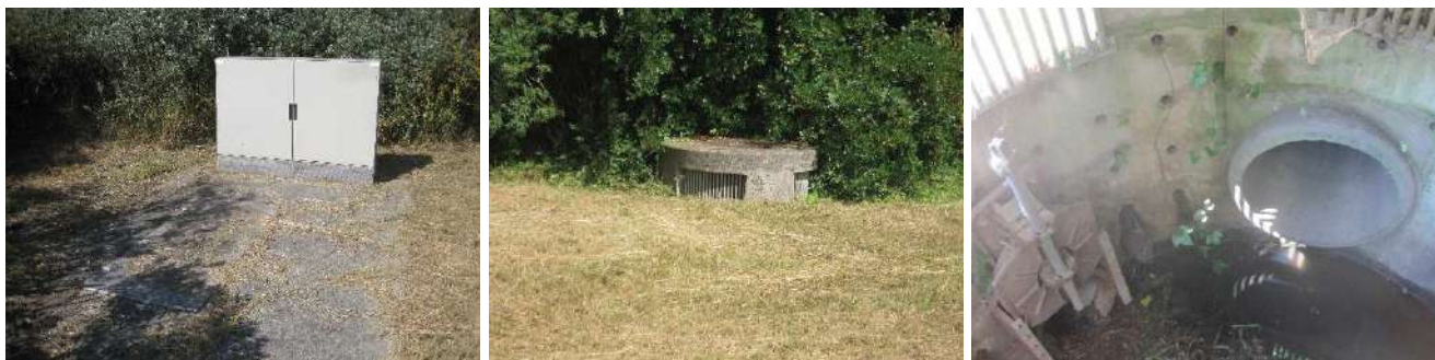
Figure 9 : vue de la station de refoulement
